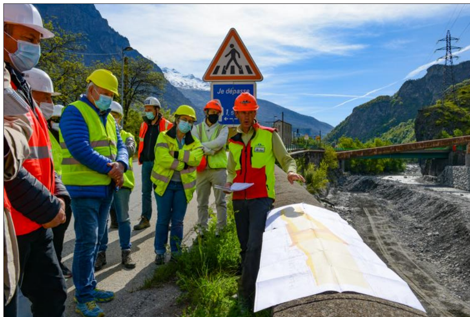
Olivier Lamy présente le chantier : sous le pont des Anglais le radier est terminé, et l'Arc est dévié rive gauche (terminée) pour réaliser les travaux rive droite.
