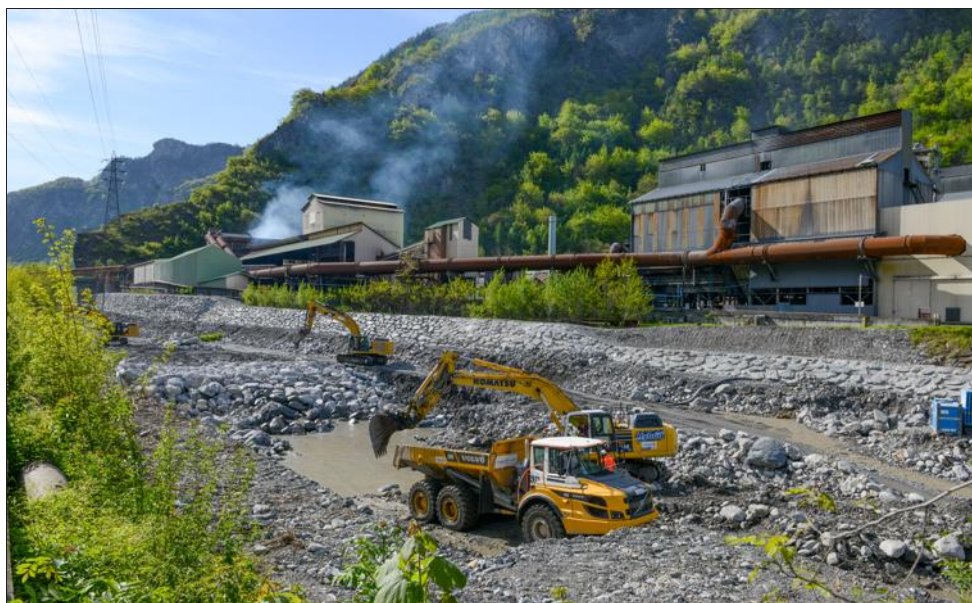
Protection sous l'usine Ferropem : alternance d'enrochements bétonnés et secs. À gauche, dans la végétation, la conduite d'eau de Saint-Jean, accrochée au soutènement de la route, fait partie des équipements à protéger.
